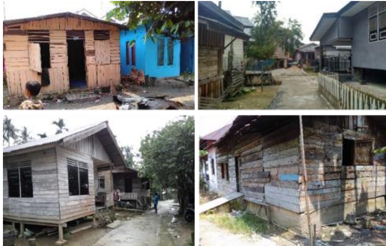
Gambar 2 Kondisi Bangunan Tidak Layak Huni
